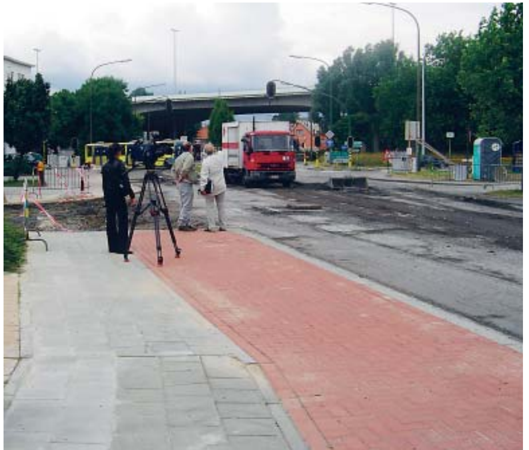
De kosten voor de herstellingswerken van het wegdek aan de St.-Antoniusvijver na de wateroverlast van 29 juni bedroegen 250.000 euro. De werken waren hoogdringend en werden dus uitgevoerd onmiddellijk bij de start van het bouwverlof
