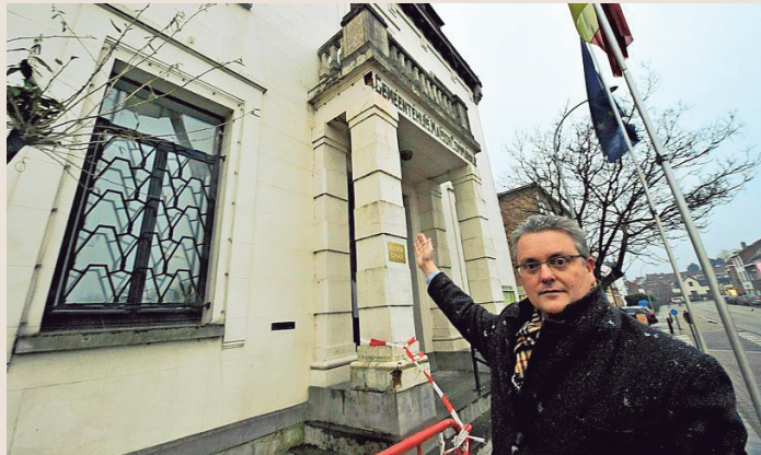
Joost Vanfleteren toont de schade aan het balkon van het oude gemeentehuis. Foto Lukas
